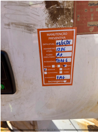
ETIQUETA DE MANUTENÇÃO PREVENTIVA
