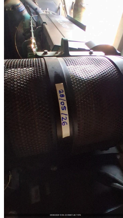
FOTO DA MARCAÇÃO DA DATA DA TROCA NO FILTRO DE AR
