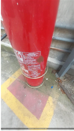
FOTO DA ETIQUETA DE VALIDADE DO EXTINTOR
