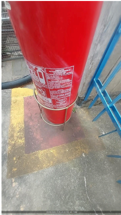
FOTO DA ETIQUETA DE VALIDADE DO EXTINTOR
