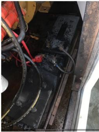
FOTO DA BATERIA
