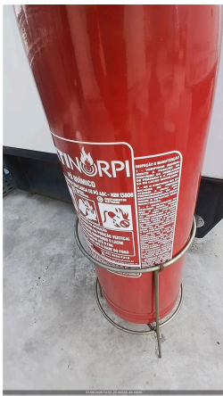
FOTO DA ETIQUETA DE VALIDADE DO EXTINTOR
