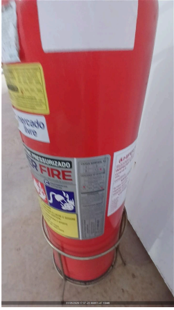
FOTO DA ETIQUETA DE VALIDADE DO EXTINTOR
