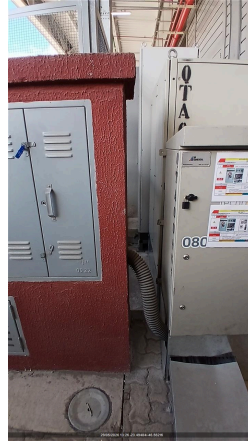
CONEXÃO DOS CABOS NO QUADRO DO CLIENTE
