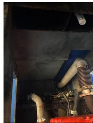
SISTEMA DE COMBATE À INCÊNDIO
