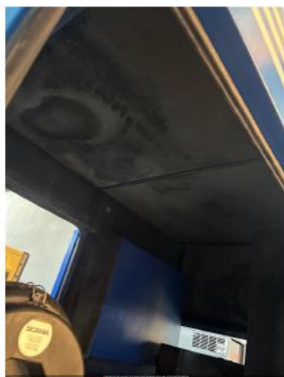
SISTEMA DE COMBATE À INCÊNDIO
