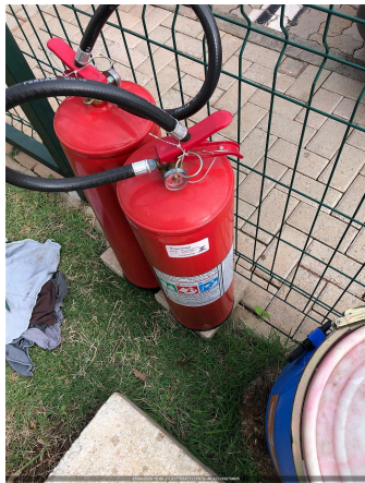
FOTO DA ETIQUETA DE VALIDADE DO EXTINTOR
