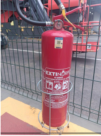
FOTO DA ETIQUETA DE VALIDADE DO EXTINTOR
