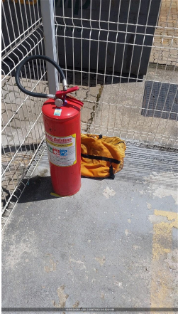
FOTO DA ETIQUETA DE VALIDADE DO EXTINTOR
