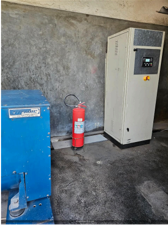
FOTO DA ETIQUETA DE VALIDADE DO EXTINTOR
