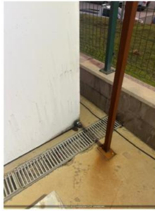
FOTO DO TAMPÃO DE DRENO DA BACIA DE CONTENÇÃO
