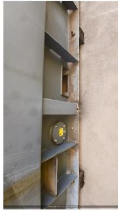
FOTO DO TAMPÃO DE DRENO DA BACIA DE CONTENÇÃO
