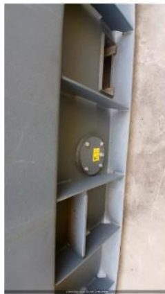
FOTO DO TAMPÃO DE DRENO DA BACIA DE CONTENÇÃO
