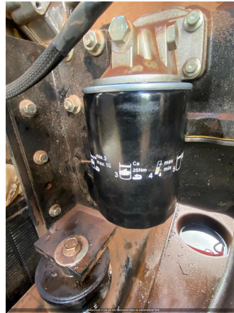
FOTO DA MARCAÇÃO DA DATA DA TROCA NO FILTRO LUBRIFICANTE
