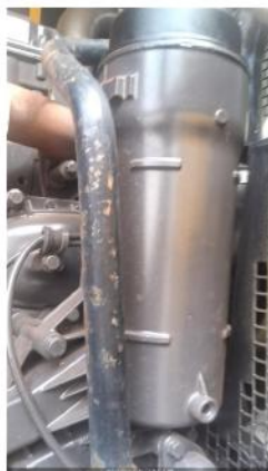
FOTO DA MARCAÇÃO DA DATA DA TROCA NO FILTRO LUBRIFICANTE
