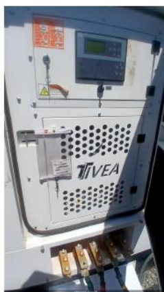
TAMPA DE PROTEÇÃO DO BARRAMENTO
