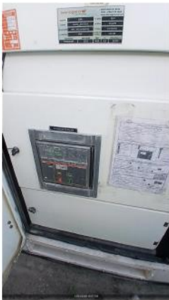
TAMPA DE PROTEÇÃO DO BARRAMENTO
