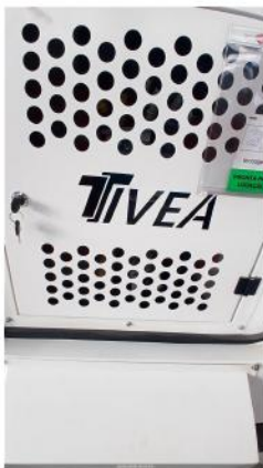
TAMPA DE PROTEÇÃO DO BARRAMENTO
