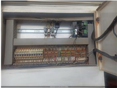
INTEGRIDADE DO PAINEL
