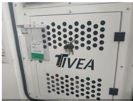
TAMPA DE PROTEÇÃO DO BARRAMENTO
