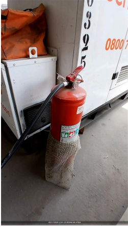
FOTO DA ETIQUETA DE VALIDADE DO EXTINTOR
