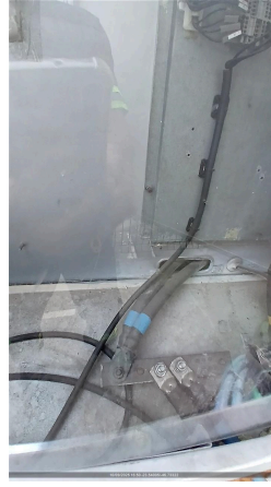
CONEXÃO DOS CABOS NO QUADRO DO CLIENTE
