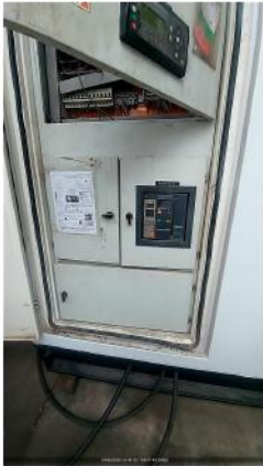
TAMPA DE PROTEÇÃO DO BARRAMENTO
